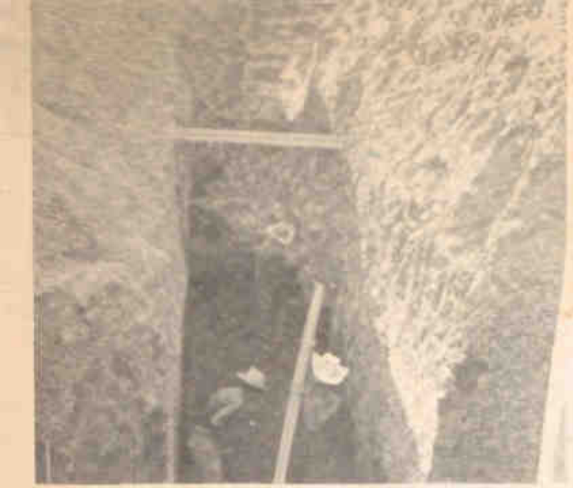
Excavación para tender tubería de drenaje de 76 centímetros de diámetro, para el colector de alivio.
