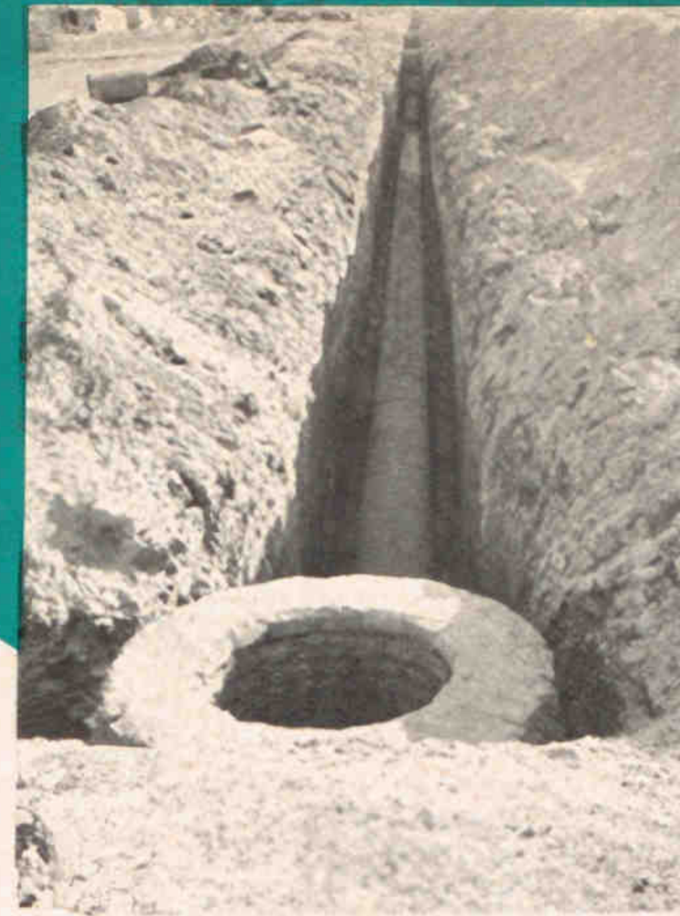
Pozo de visita y tubería de drenaje de 60 centímetros de diámetro. Obra del colector de alivio de Ciudad Obregón.
